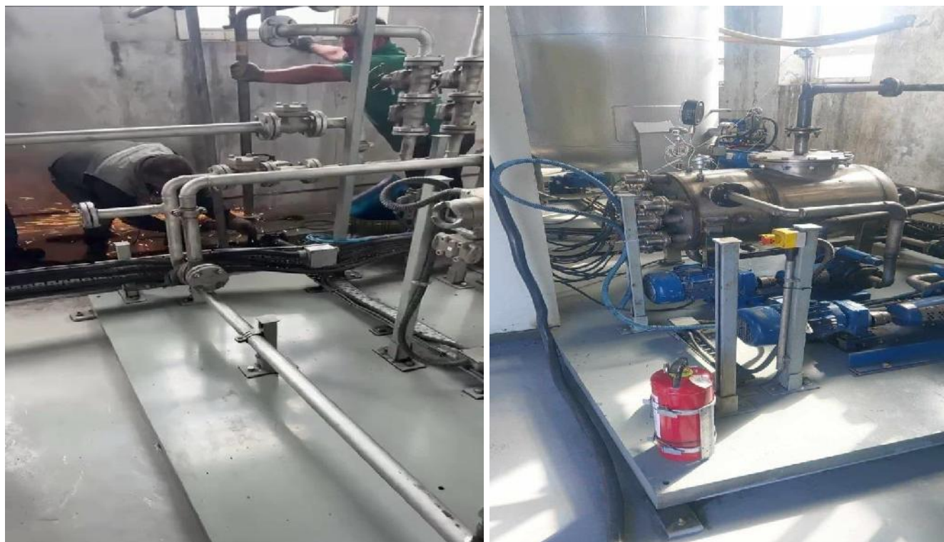
Зураг 16. Үйлдвэрийн тоног төхөөрөмжний засвар үйлчилгээ
